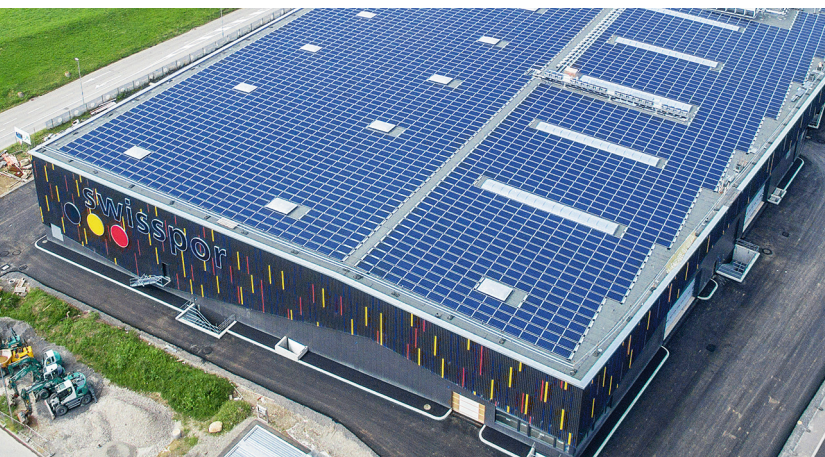
Près de 6'800 m² de panneaux solaires ont été posés sur les toits de swisspor à Châtel-St-Denis, couvrant l'équivalent de la consommation électrique d'env. 300 ménages par an.
